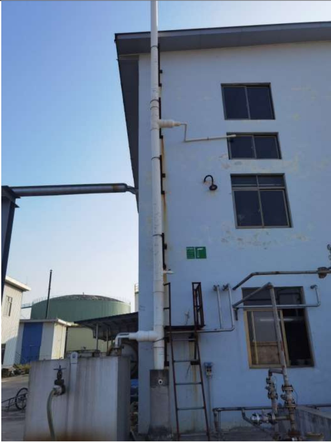
硫化氢吸收处理废气排放口
