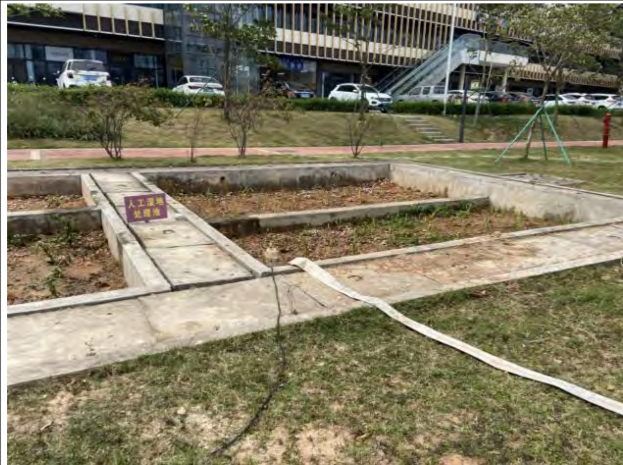
人工湿地污水处理设施 2 及回用管道
