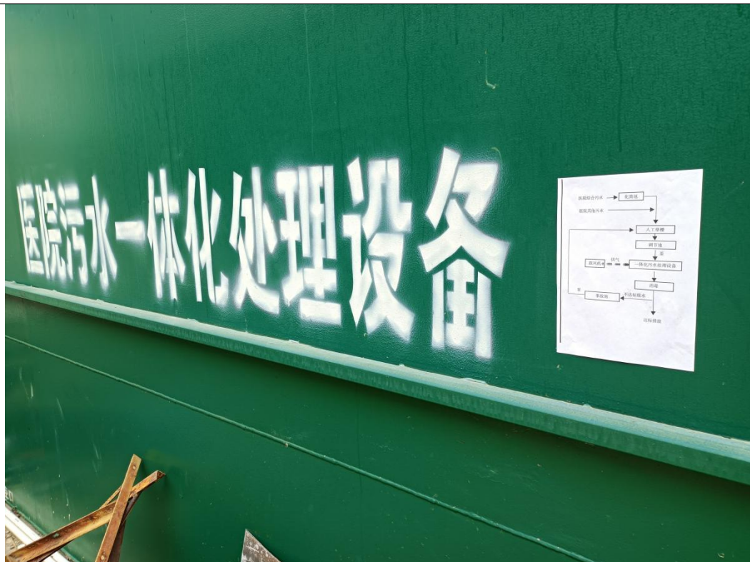
污水一体化处理设施
