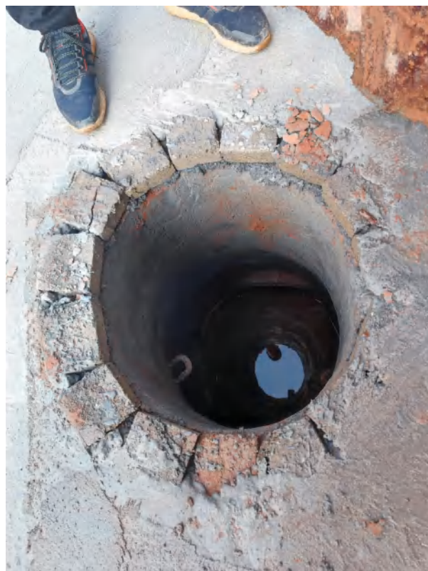
市政接入污水井
