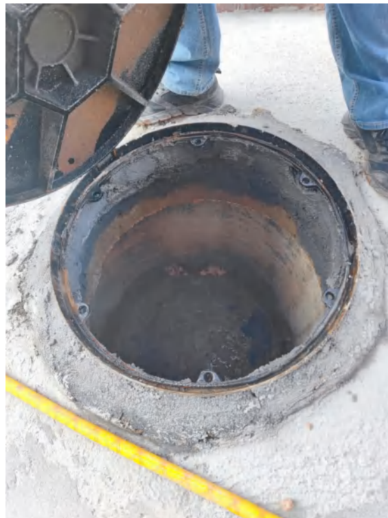
雨水排放口图片
